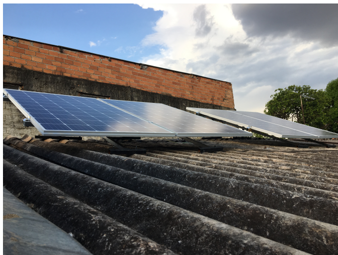
Figura 3.3: Sistema fotovoltaico de 1,22 kWp.
