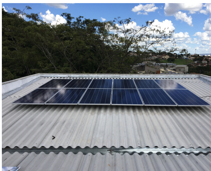
Figura 3.4: Sistema fotovoltaico de 3,96 kWp.
